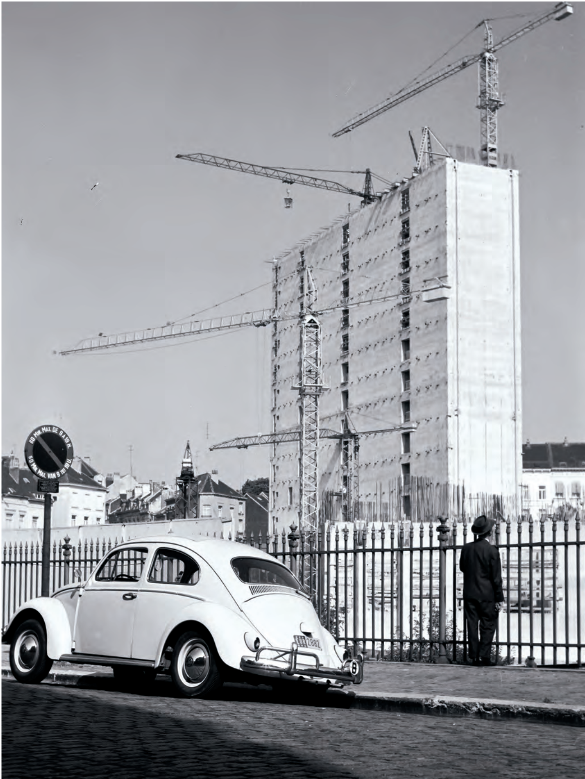
Bruxelles, 30 septembre 1964, le bâtiment Berlaymont en construction. L'édifice est bâti aile par aile. Prévus pour 1964, la première aile ne sera achevée qu'en 1967. La direction générale de l'agriculture s'y installera.
